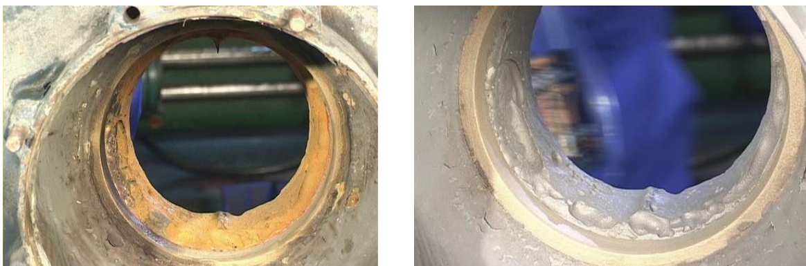
Рис. 2. Износ внутренней поверхности улитки центробежного насоса
